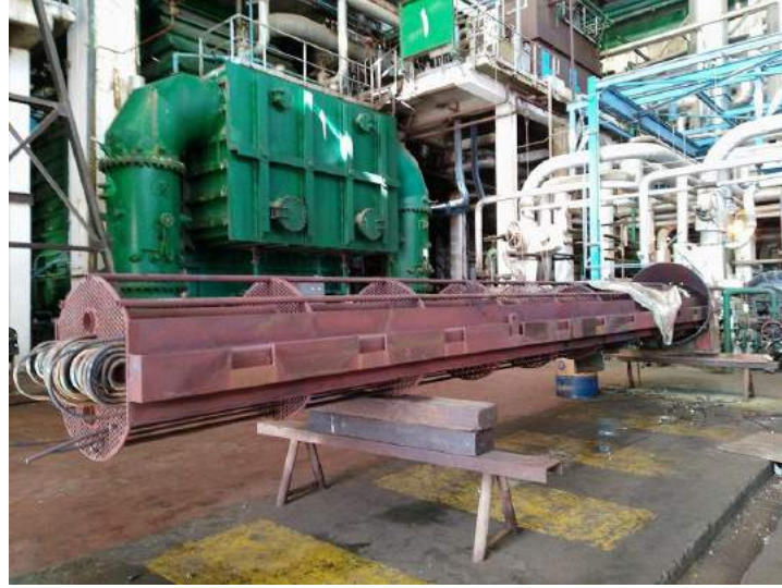
هيكل مواسير السخان كاملا ( محطة كهرباء أبوقير )
